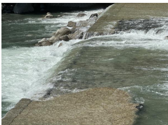
[ 堰堤の一部欠損 ]
