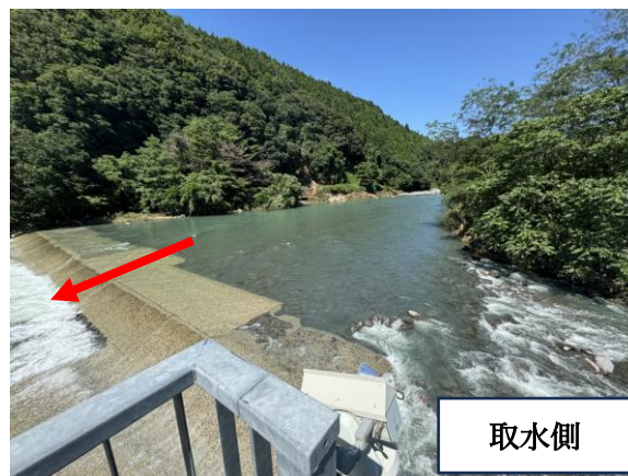
[河床変化による取水漏れ]
