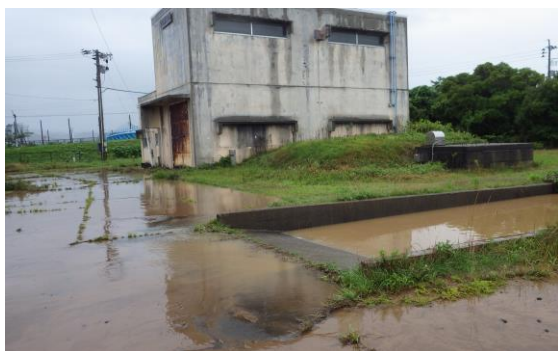
[ 宮内 揚水機場（被災後） ]
