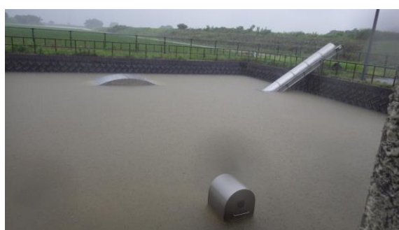
[福島揚水機場敷地内（水没時）]
